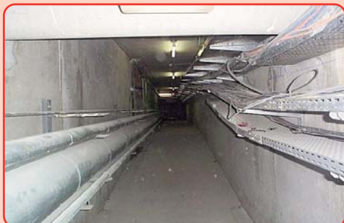
Galerie de câble
